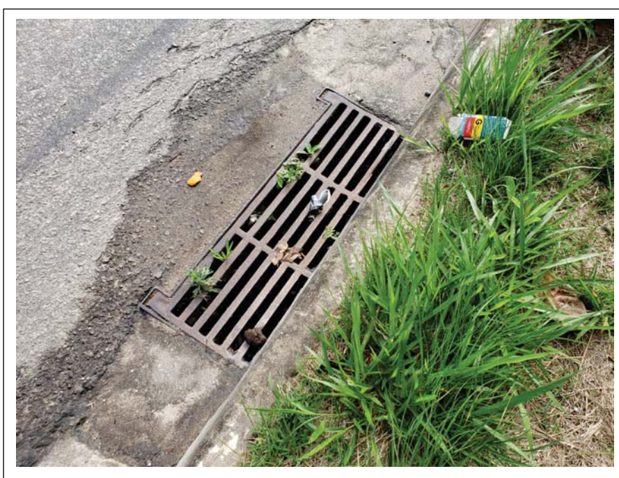
figura 12. - Infra Estrutura - rede drenagem pluvial
