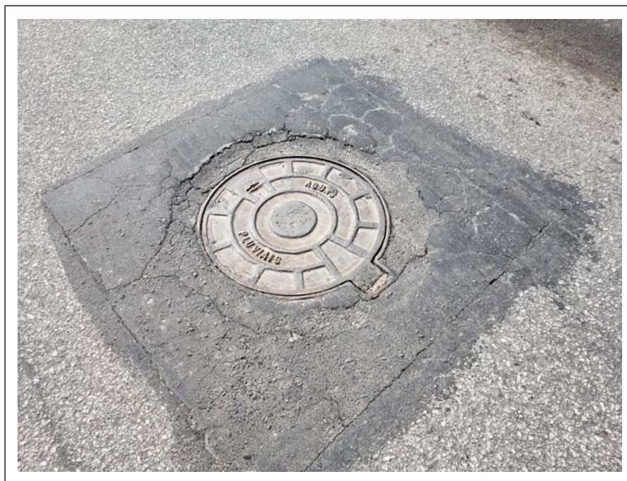
figura 13. - Infra Estrutura - rede pluvial
